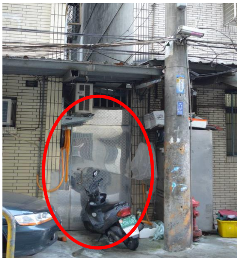
防火巷被搭建圍成私人倉庫
